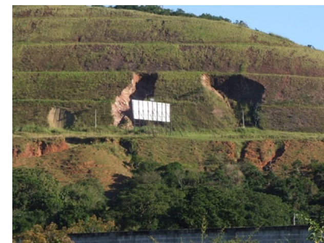
Escorregamentos em talude de corte e ravinas profundas no talude de aterro da estrada. (Coordenadas 23K 599472/7464004)
