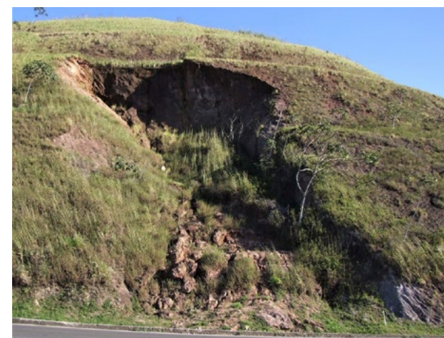
Escorregamento de talude na margem da rodovia. (Coordenadas 23K 599360/7463457).
